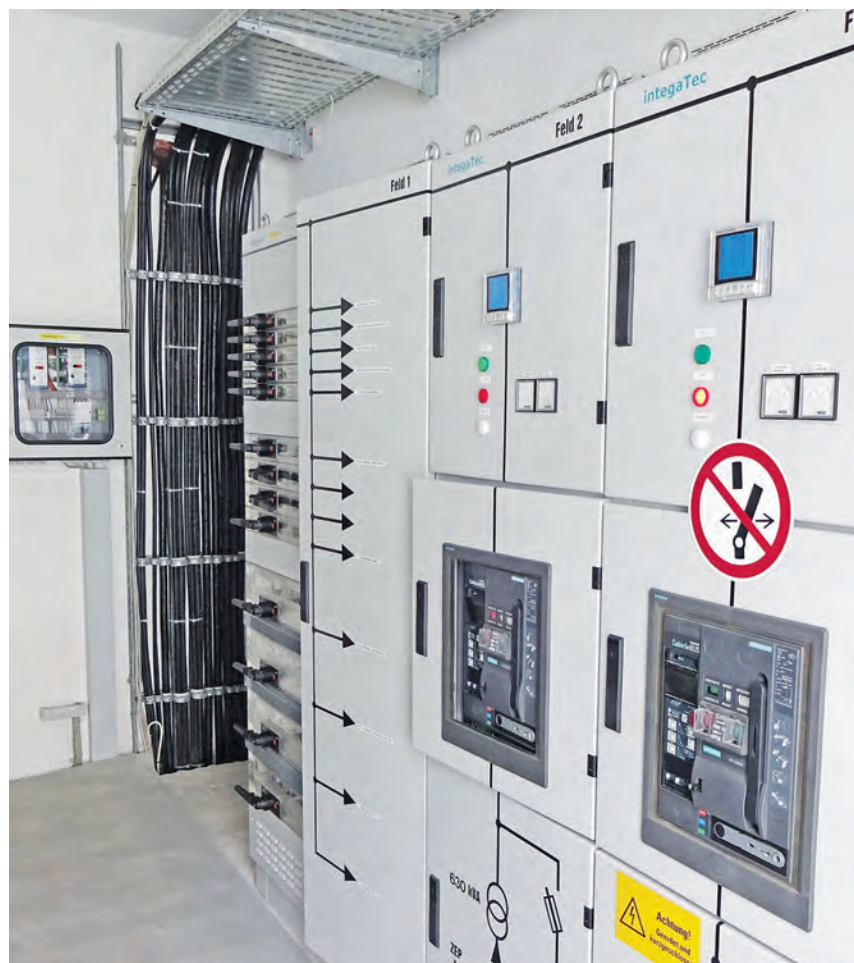
Komplexität im Gewerbebetrieb: Schaltschrank von Schrödl montiert
