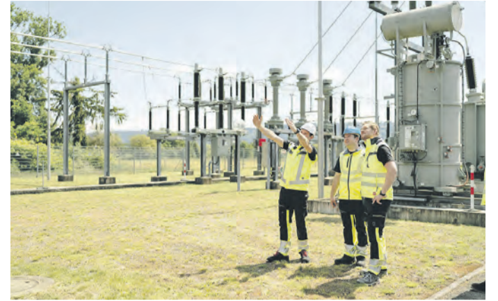
Das Umspannwerk Rielasingen: Ein wichtiger Standort für die zuverlässige Stromversorgung in Singen und Umgebung.
