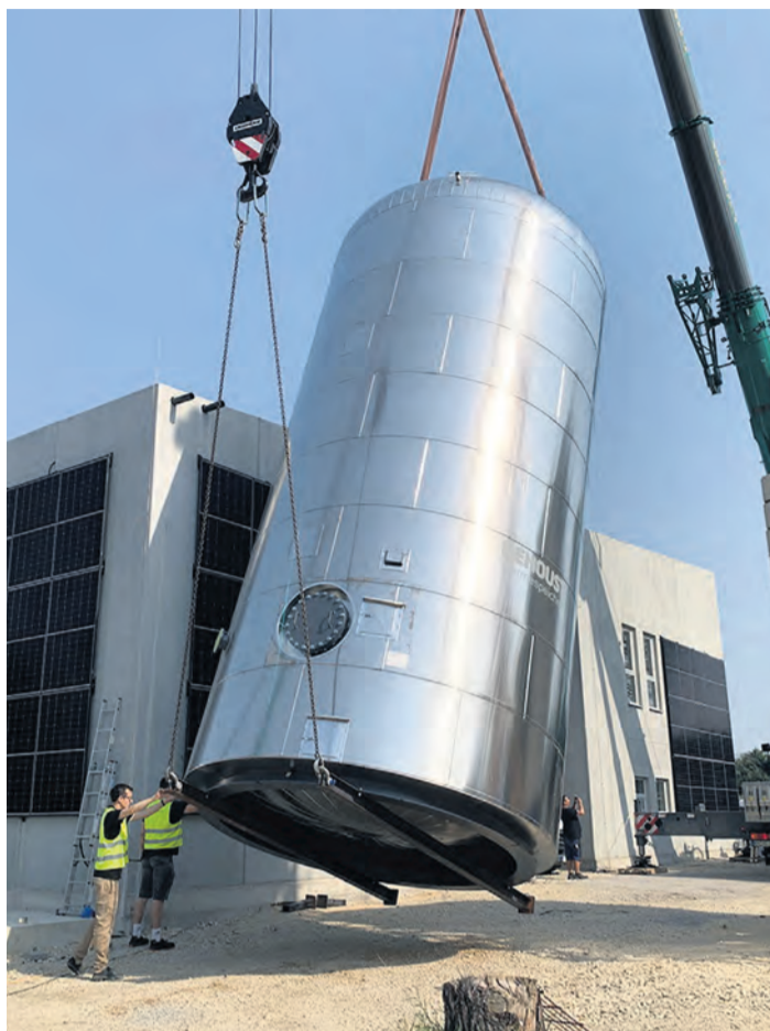
Mit der neuen Tranche Genussscheine von solarcomplex sollen auch in Zukunft Projekte wie hier das Wärmenetz in Hilzingen finanziert werden. swb-Bild: solarcomplex
