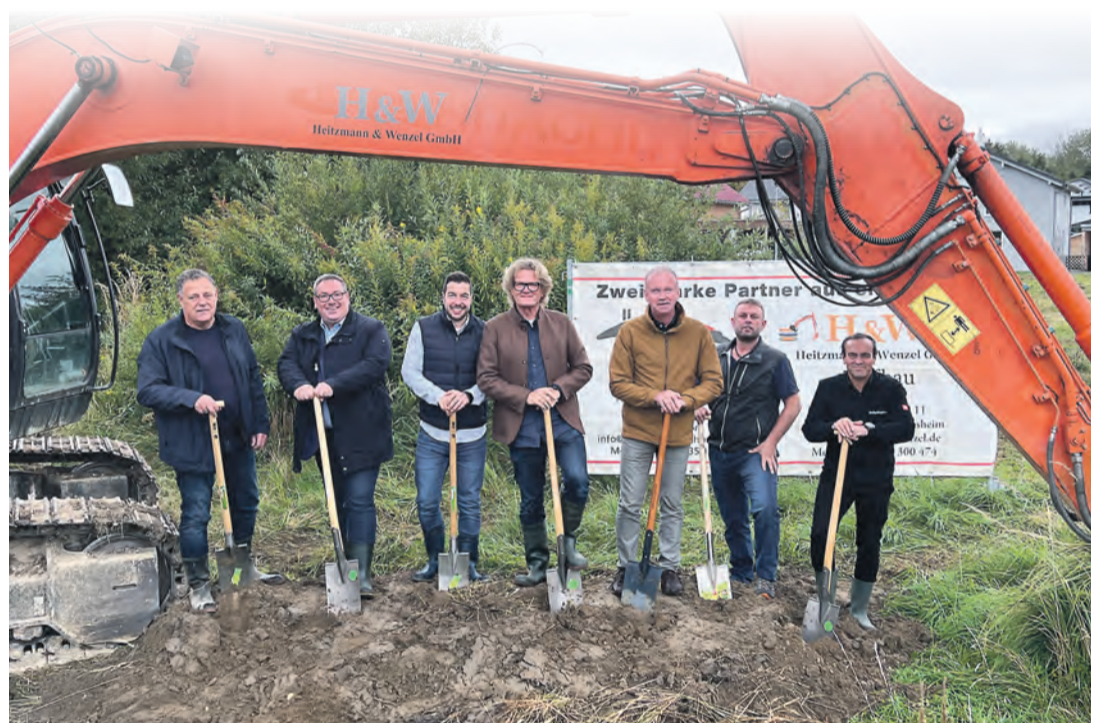
Der Spatenstich erfolgte im Oktober 2024. Nach nur elf Monaten Bauzeit konnte der Neubau erfolgreich eröffnet werden. swb-Bild: extrutec
