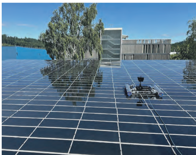
Reinigungsservice Karrer reinigt Ihre Photovoltaikanlage – egal ob in gewerblichen oder privaten Haushalten. swb-Bild: Reinigungsservice Karrer
