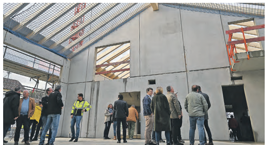
Das Interesse am neuen Feuerwehrhaus in Winterspüren war groß und viele nutzten die Gelegenheit, am Richtfest einen Blick in den Bau zu werfen. swb-Bild: Tobias Lange
