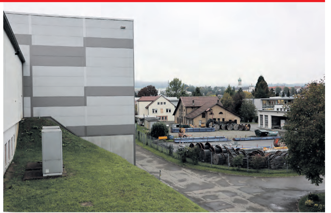
Der Hang zur Gaswerkstraße musste abgetragen und abgesichert werden, damit hier die neue Halle entstehen kann.
