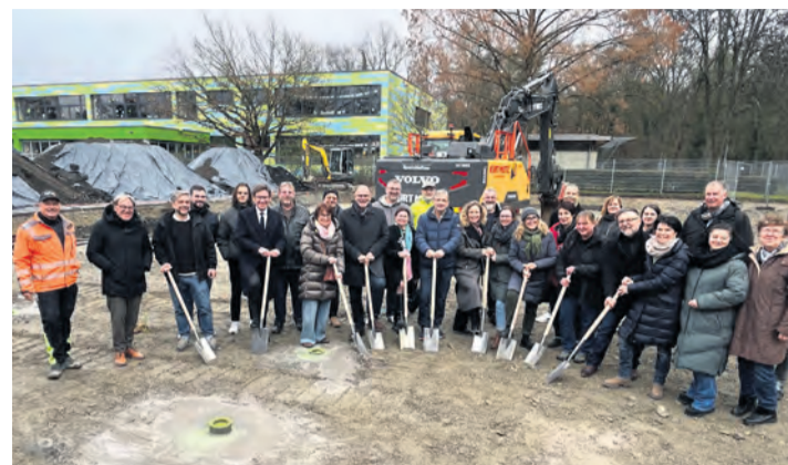
Der Spatenstich für einen Mensaneubau ist erfolgt. Fertigstellung ist für das erste Quartal 2027 geplant. sub-Bild: Stadt Singen
