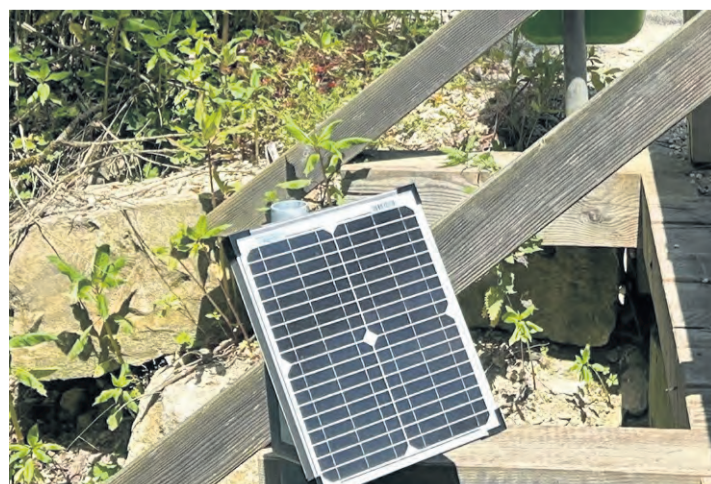
„Noysee“ soll vor hohen Pegelständen warnen. In Stockach und Eigeltingen ist das System mit solarbetriebenen Sensoren schon im Einsatz. swb-Bild: Archiv
