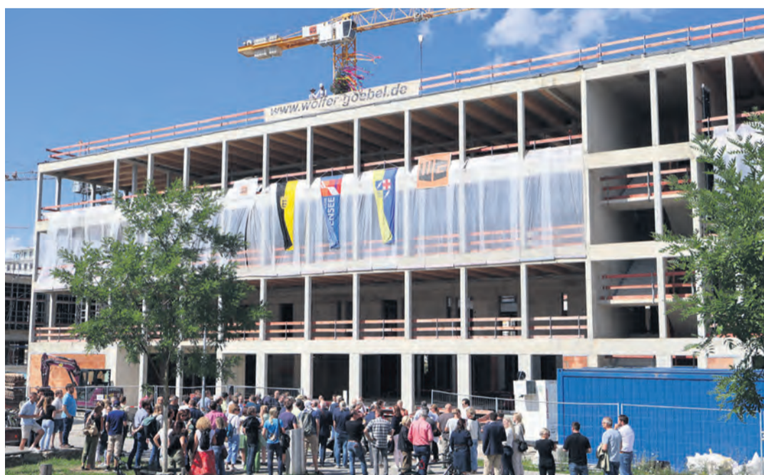
Der Rohbau und der Dachstuhl stehen. Nun stehen die Feinarbeiten beim Bau des neuen Berufsschulzentrums an. swb-Bild: Tony Marquardt
