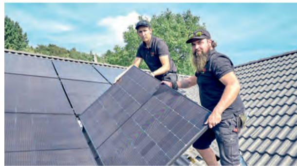
Zimmerei - Holzbau Heinrich Mohr GmbH aus Hilzingen im Auftrag der Thüga Energie bei der Montage einer 10 Kilowatt-Peak-Anlage.
