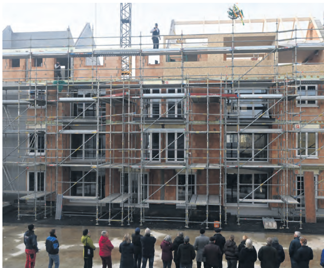
Ein neues Gebäude nimmt Form an in der Fliederstraße in Gottmadingen. Zum traditionellen Richtspruch für den Neubau mit 22 Wohneinheiten blickten die Gäste gespannt in die Höhe.
