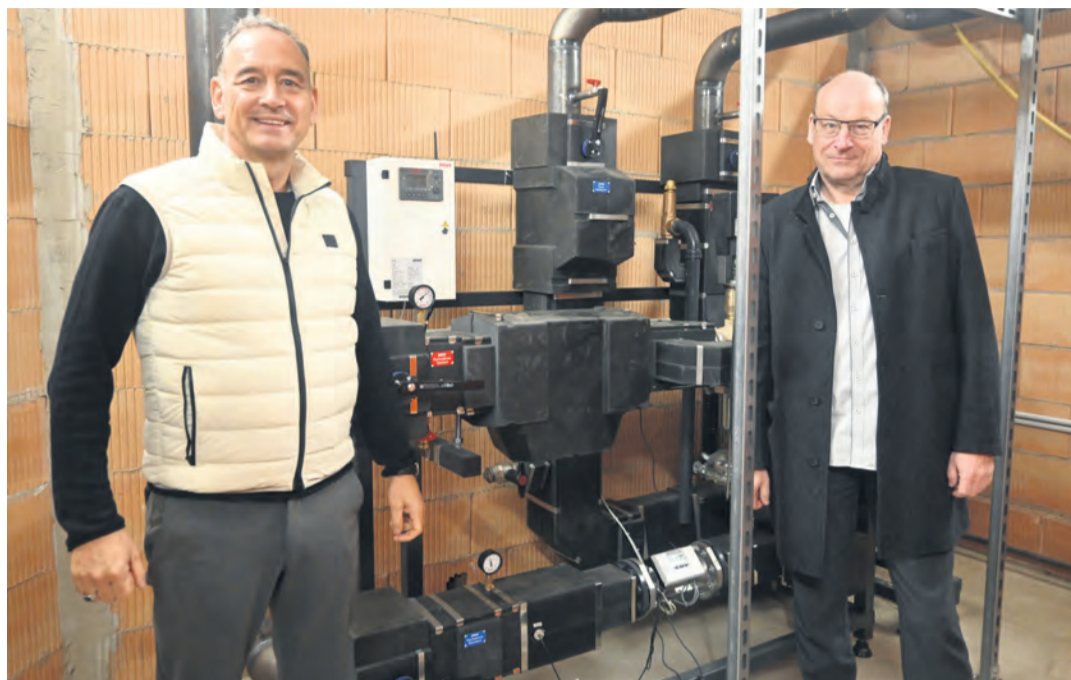
Axel Mauch, Geschäftsführer der Gärtnerei Mauch (links), und Bene Müller, Vorstand von Solarcomplex, freuen sich, dass die neue Wärmeübergabestation in Betrieb genommen werden konnte.
