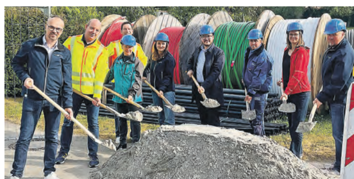
Viele Hände packen gemeinsam an bei der umfassenden Modernisierung des Stromnetzes und dem ersuchten Breitbandausbau für ein »Turbo-Internet« im Ortsteil Weil der Stadt Tengen.
