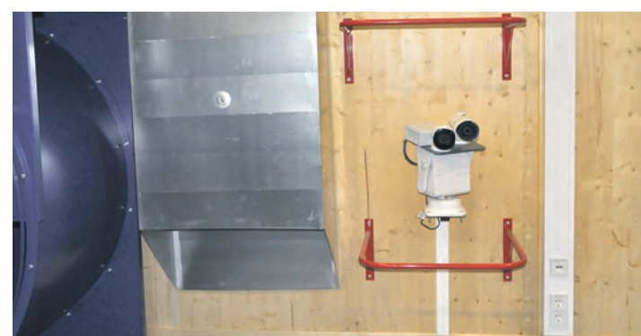
Auch die Atemschutzstrecke verfügt über Kameraüberwachung, sowie einen Abzug, der im Notfall den Nebel aus dem Raum zieht.
