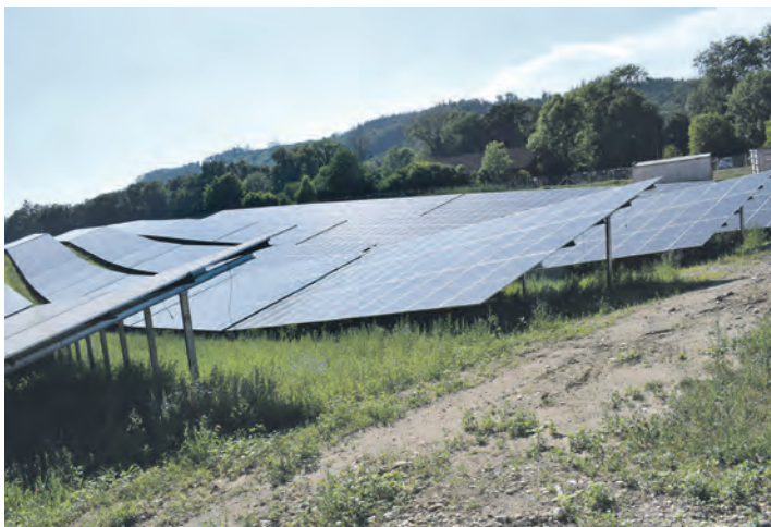
Mit dem Solarpark Katzental in Gottmadingen realisiert Solarcomplex eines von zwei Projekten in der Gemeinde.swb-Bild: Achim Holzmann
