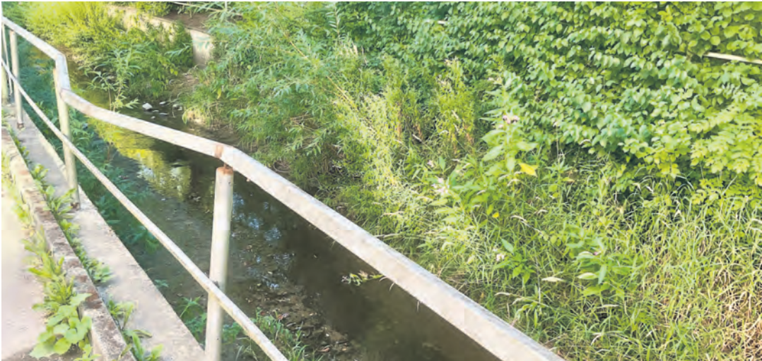
Nach dem Willen des Gottmadinger Bürgermeisters Dr. Michael Klinger und dem einstimmigen Votum des Technischen Ausschusses soll der Absturzschutz beidseits des Riederbachs ersetzt werden. swb-Bild: Bernhard Grunewald
