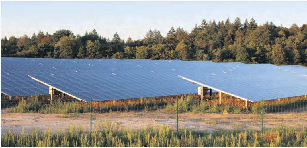
Der E.ON-Solarpark bei Mühlhausen-Ehingen produziert bereits Strom aus Sonnenenergie. Ein geplanter Batteriespeicher soll die erzeugte Energie künftig zwischenspeichern. sub-Bild: Eron Metolli
