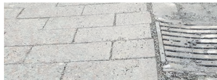
Stolperstellen entstehen oft durch Absenkungen des Bodenbelags oder wackelnde Pflastersteine. swb-Bild: Stadt Radolfzell
