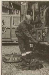
Mit Wasser, das mit hohem Druck in die Leitungen gepumpt wird, können Rohre genauso gereinigt werden wie mit sogenannten elektromechanischen Methoden.
