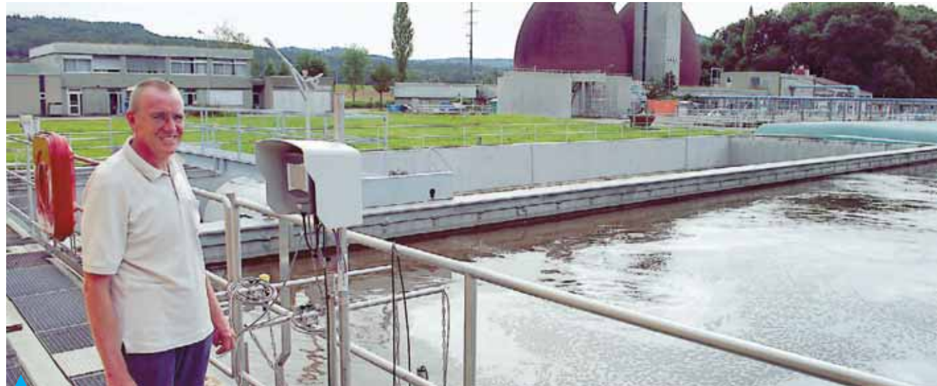
Eine neue Anlage zur Vorbehandlung von Abwässern aus der Klärschlamm-trocknung wurde nun in der Kläranlage Ramsen in Betrieb genommen. Die Kläranlage wird dadurch erheblich leistungsfähiger. Im Bild der Leiter der Kläranlage, Klaus Bölling. Bild: of
