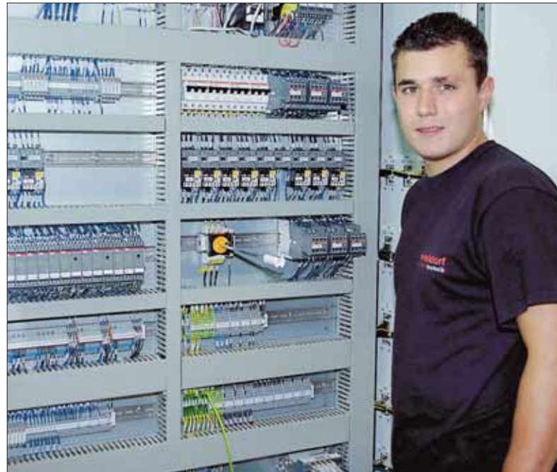
Johannes Ritzi am Schaltschrank einer Spritzgussanlage, die nach dem Probelauf wieder abgebaut und beim Kunden aufgebaut wird. Beim Engener Unternehmen Waldorf-Technik hat er einen sehr interessanten Ausbildungsplatz gefunden. Johannes Ritzi hatte nach dem Besuch der Hauptschule in Tengen die zweijährige Fachschule für Elektrotechnik in Singen absolviert und weiß aus Erfahrung: nicht erst warten, bis man Adressen zur Bewerbung von der Arbeitsagentur bekommt, sondern selbst Initiative ergreifen.
