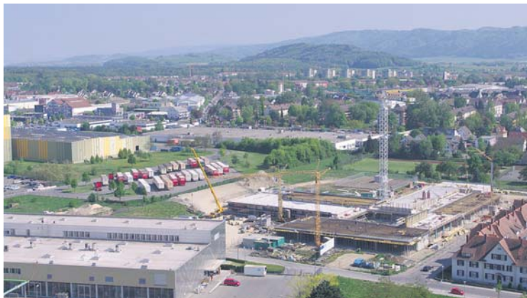
Die Baustelle der neuen Bildungsakademie der Handwerkskammer Konstanz, vom Hegau-Tower aus gesehen. Am 28. Mai soll Richtfest gefeiert werden. swb-Bild: of
