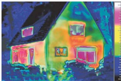
Die Kältebrücken zeigt uns die Aufnahme der Wärmebildkamera.
