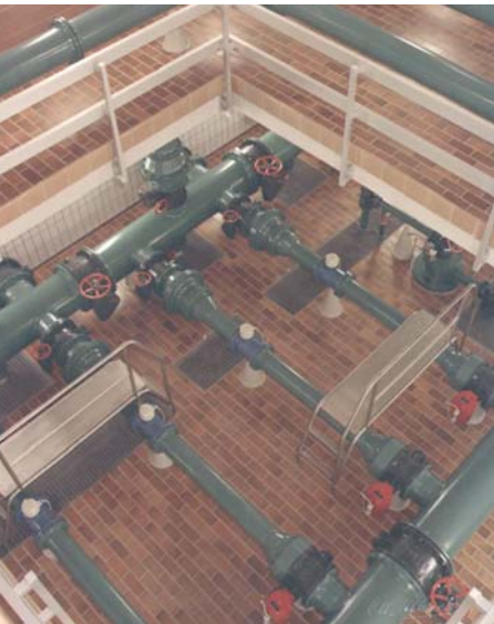
Der Hochbehälter Buchberg von innen: Der Rohrkeller mit den Ein- und Auslaufleitungen.
