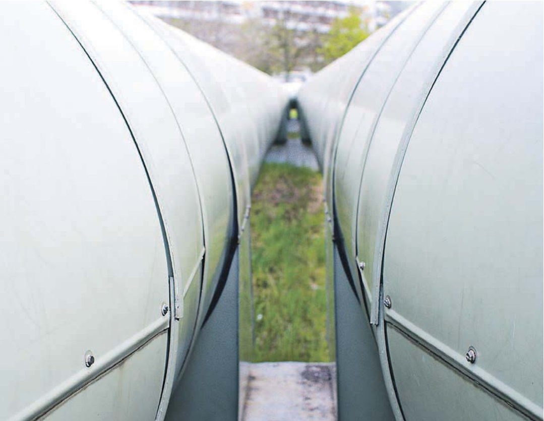
Dank Fernwärme wird der CO 2 Ausstoss deutlich reduziert. swb-Bild: BTH_Fernwaerme_shutterstock_272898995
