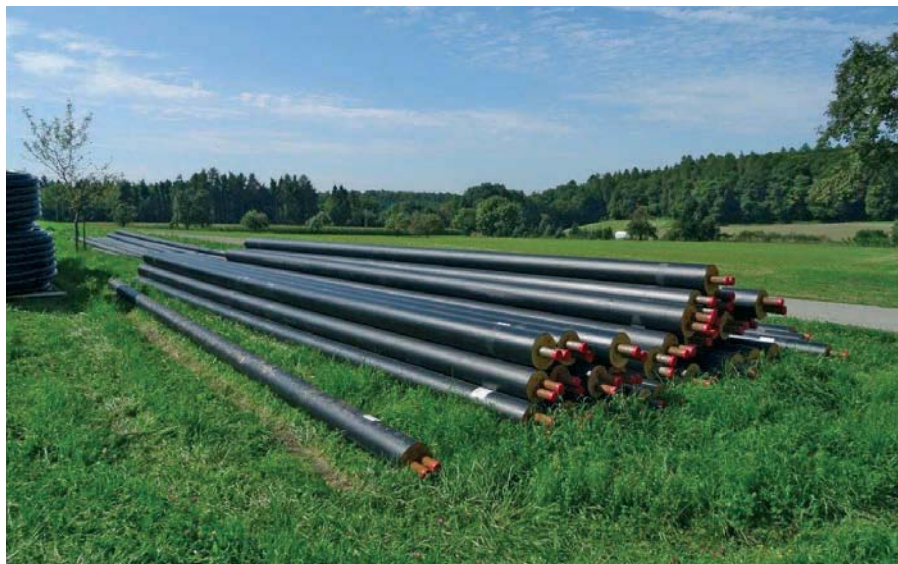
Lagerung der Wärmeleitungen nahe der Litzelhardthalle.
