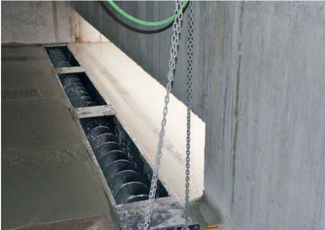
Die sogenannte Lieferschnecke befördert die Holzhackschnitzel in den Holzhackschnitzelkessel.
