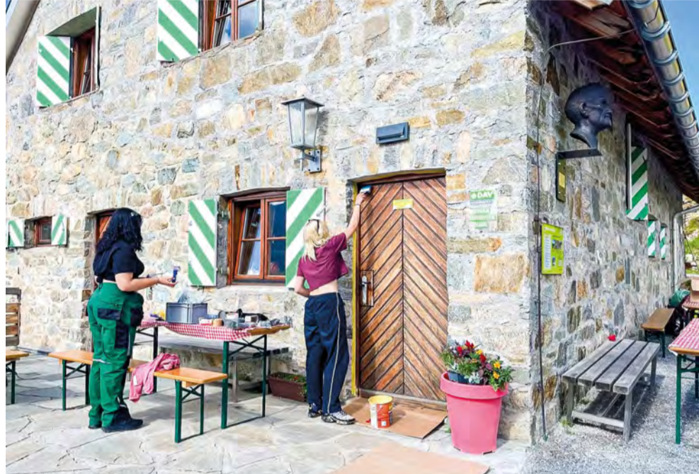
Bei der Handwerksstatt des BSZ waren 15 SchülerInnen und zwei LehrerInnen, Holger Mauritz und Nadine Gabele, im österreichischen Galtür, um an der dortigen Friedrichshafener Hütte Renovierungsarbeiten durchzuführen.
