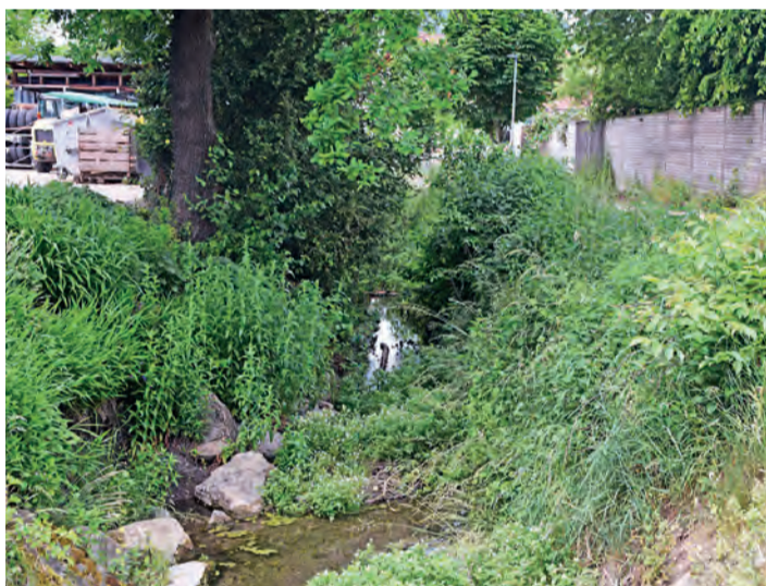
Der Gießwiesengraben im Gewerbegebiet Gießwiesen verläuft teilweise zwischen den Straßen Obere Gießwiesen und Untere Gießwiesen und ist größtenteils zugewachsen.
